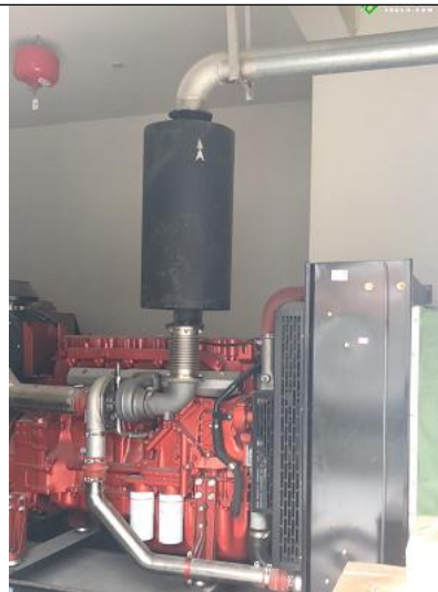
现有发电机消烟除尘装置：
