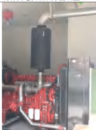
现有发电机消烟除尘装置：
